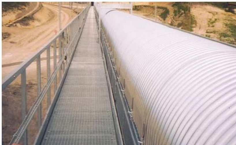
Рис. 12. Закрытый ленточный конвейер
