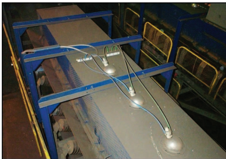
Рис. 11. Сопла и корпус системы Dustex в зоне загрузки материала на ленточный конвейер
